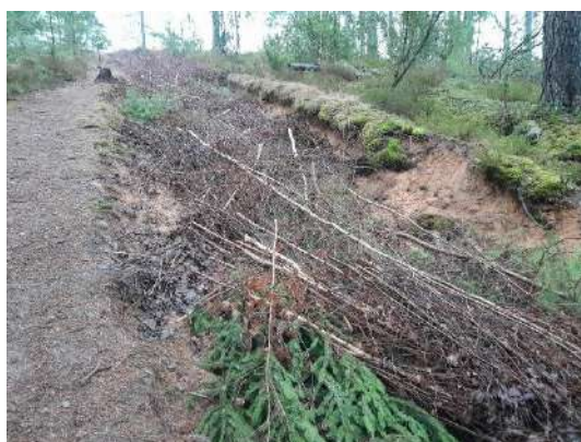
1.1.61. attēls. Erodētās rietumu nogāzes stiprinājums ar izvāktajiem bērziem un priedēm. Foto: Vija Kreile, 29.01.2025.
